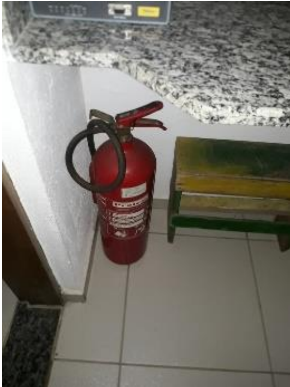
Figura 3: Extintores de incêndio mal condicionado.
