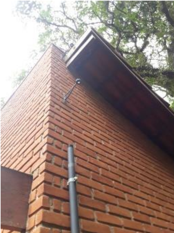
Figura 8: Fita de Para-raios falta cabo de aço.
