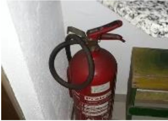
Figura 5: Extintores de incêndio sem lacre de segurança.
