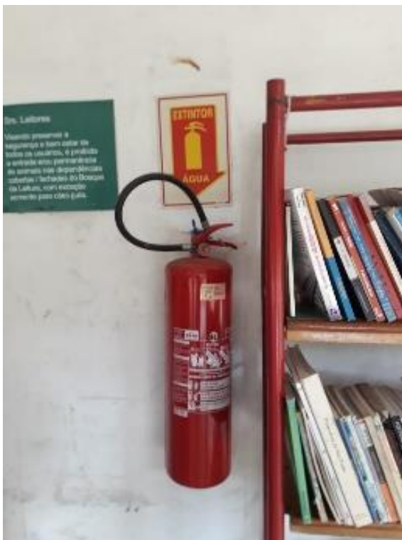
Figura 1: Extintores de incêndio com sinalização inadequada.
