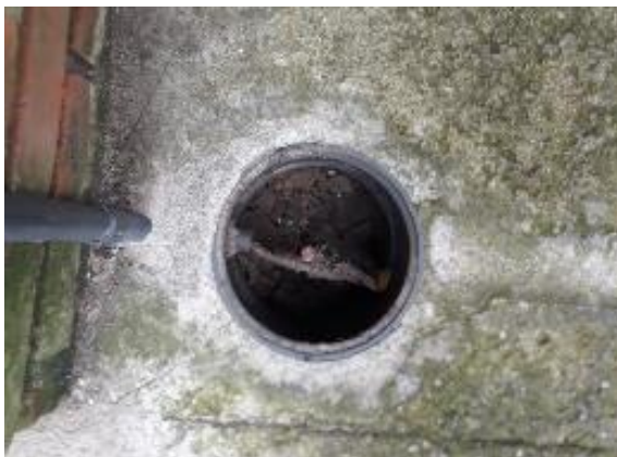
Figura 7: Caixa de inspeção do para-raios em mau estado de conservação (Sujo).
