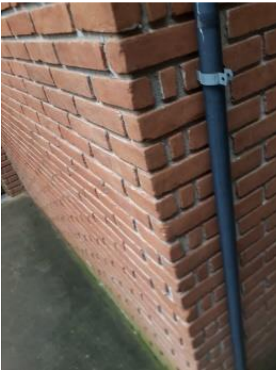
Figura 9: Instalações do para-raios com falta de grampo. (Peça que prende o conduíte).
